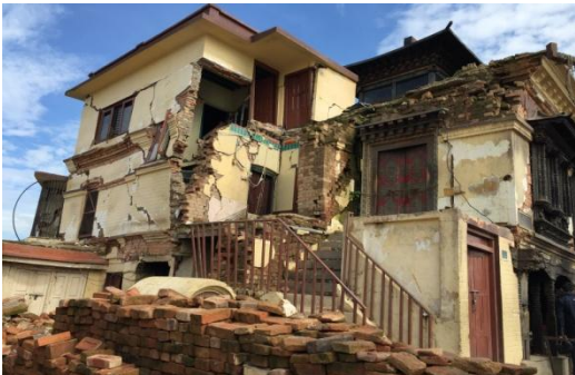
角地にある壊れた古い建物
