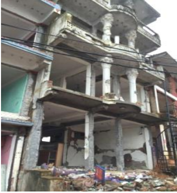
被災した建物
